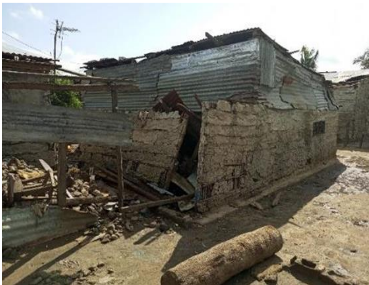
Figura 5. Efeitos destrutivos do ciclone Freddy no Bairro Novo
