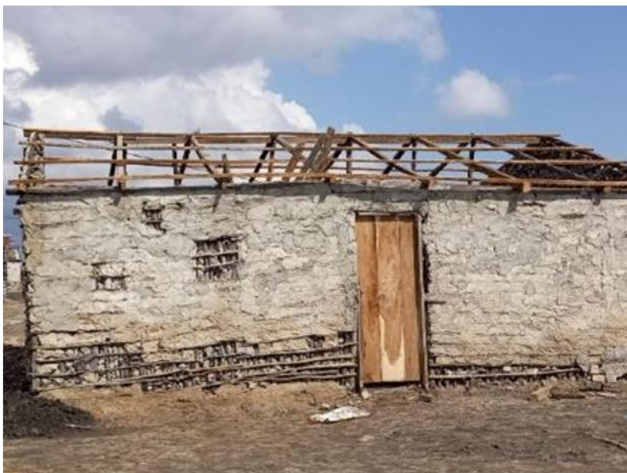
Figura 3. Efeitos destrutivos do ciclone Freddy no Bairro Novo
