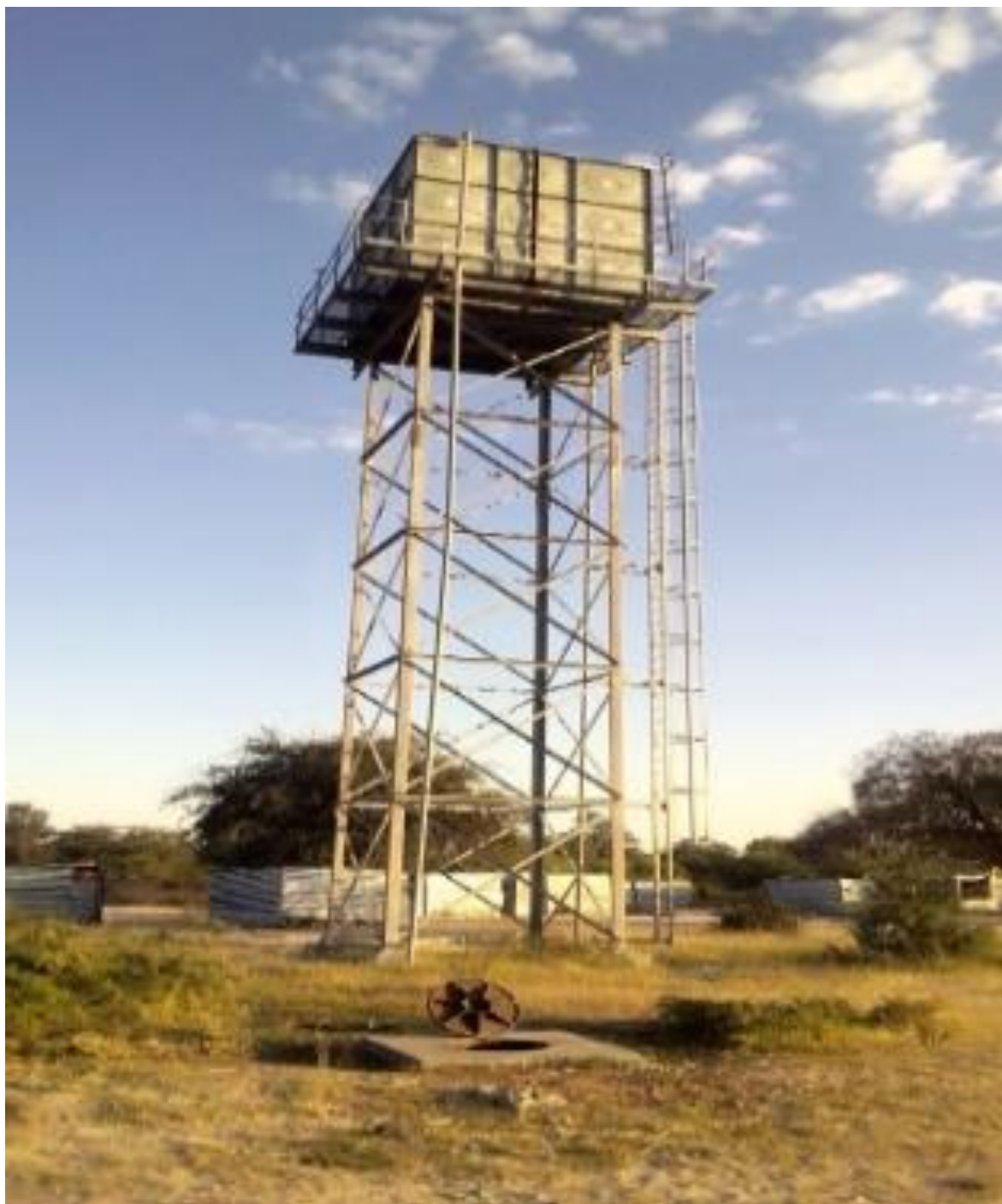
Figura 7: Reservatório aéreo na localidade de Oifanyama, povoação de Anhanca.
